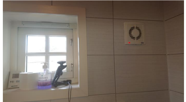
El.avtrekksventil i yttervegg.
