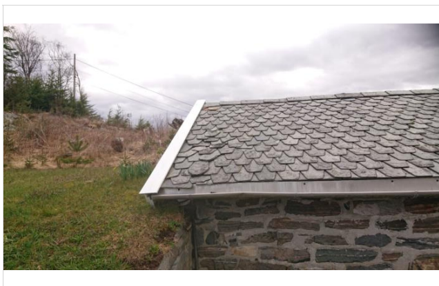
En del løse stein på garasjetak.
