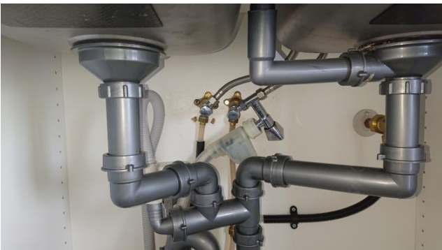
Vannstopp på vannledning var montert.
